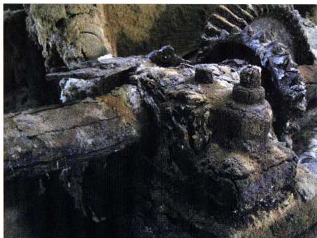
Palier non utilisé - palier et axe déformés
